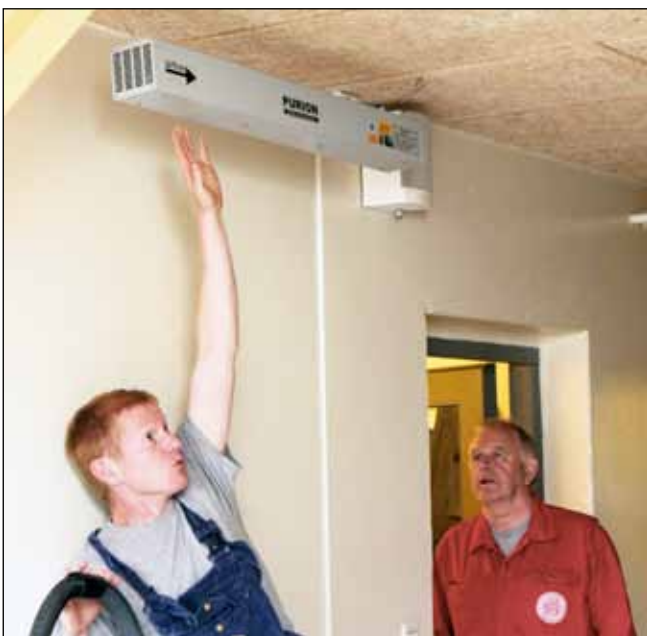
Der hvor man træder ind i stalden, renses luften ved at blive ledt gennem en Airpuriion - én før og én efter badefaciliteterne. Her efterfølgende den ene af Jørgen Skou Hansen, mens Kai Skou Hansen ser til.
