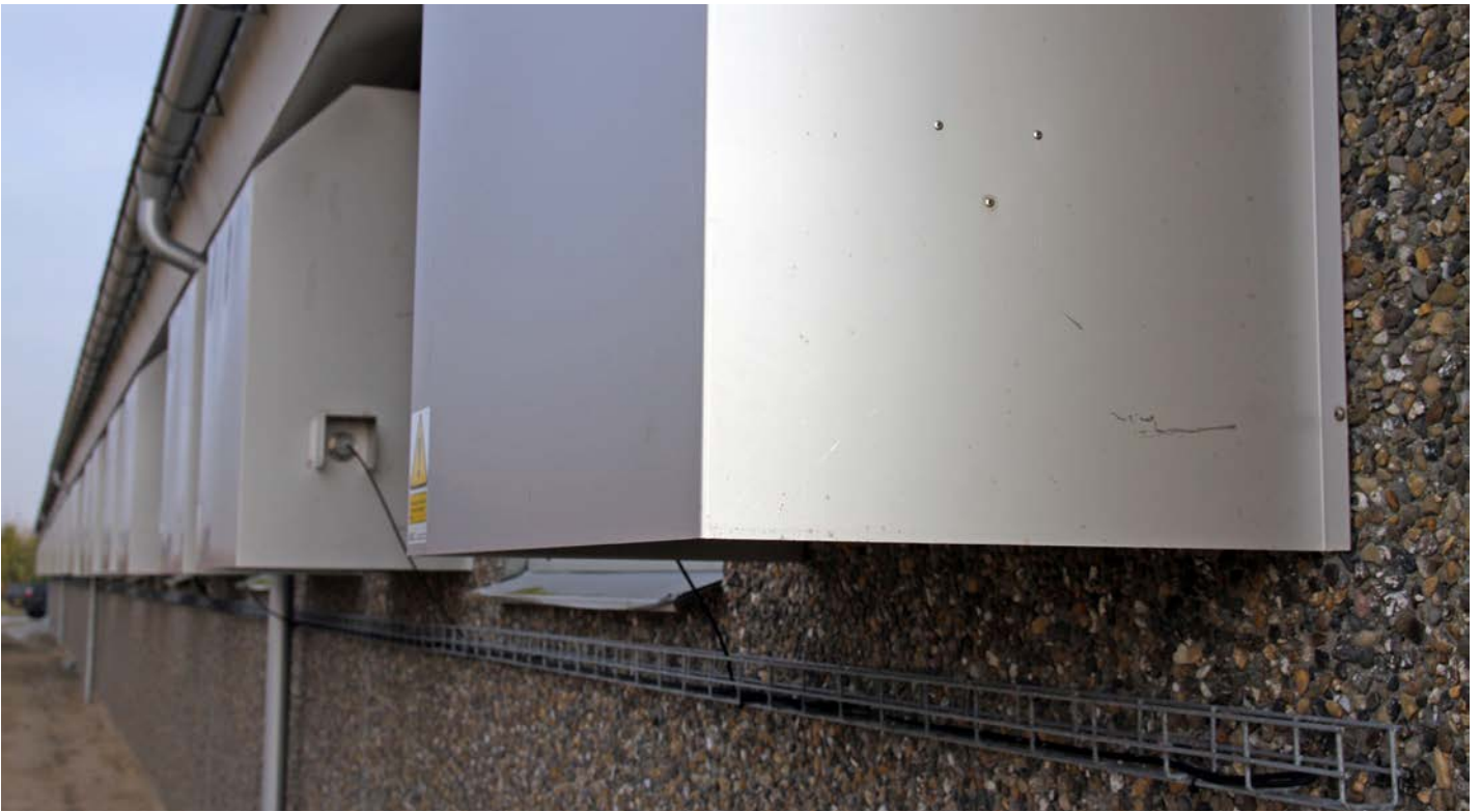
Stålkasserne fører luften ind fra bunden, og forbi en UV-pære inden den kommer ind i stalden gennem almindelige vægventiler.
